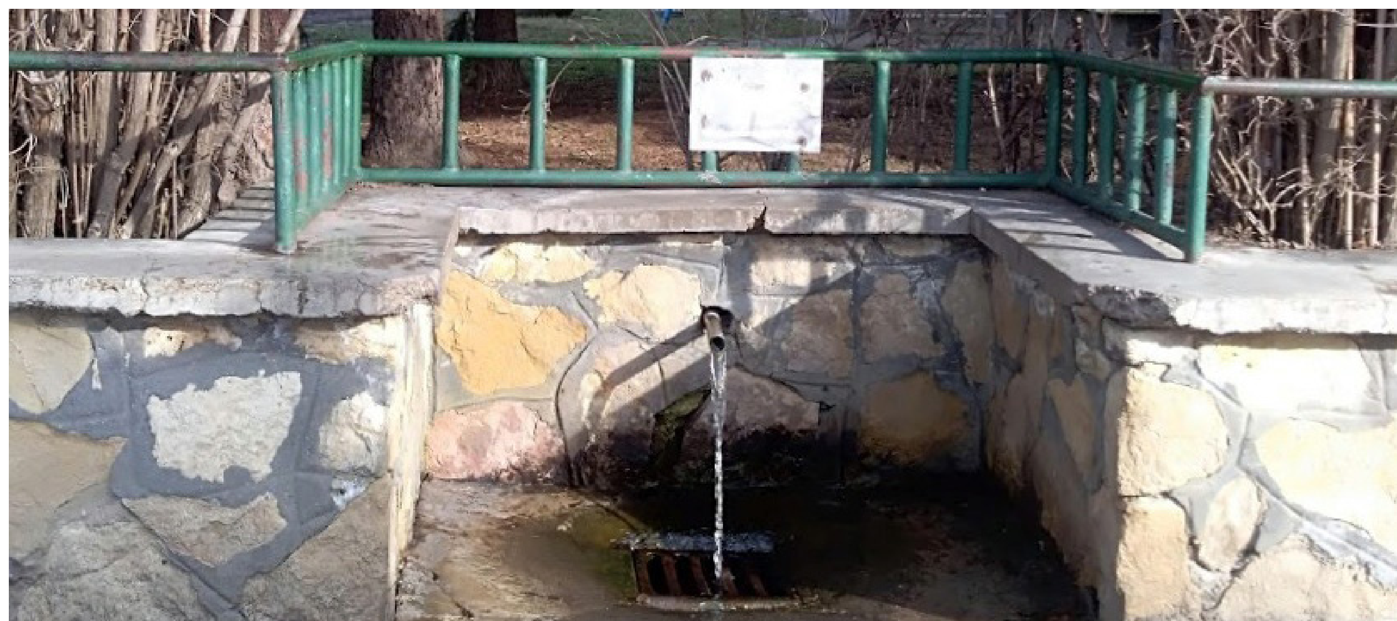
A Part utcai kút közkfolyója jelenleg is üzemel
