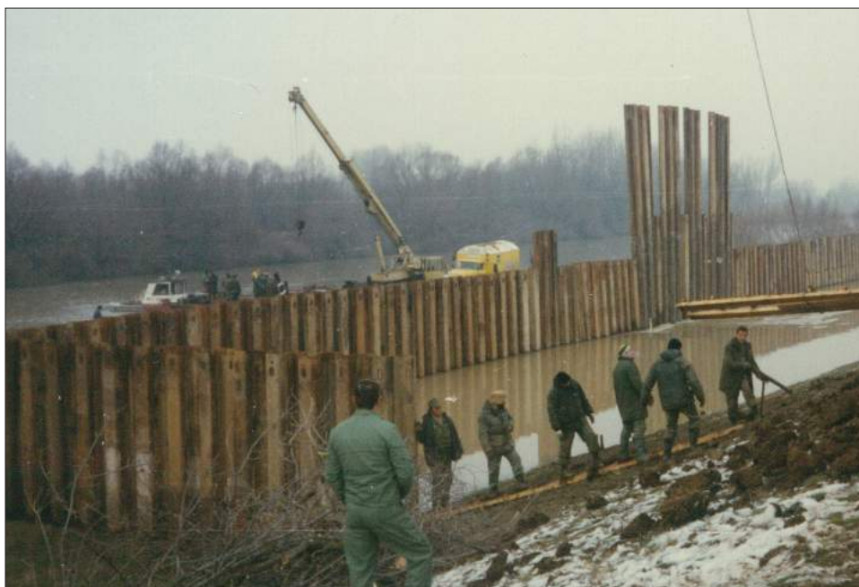
Víz visszavezetés a Mérgesi árvízi szükségtározónál
